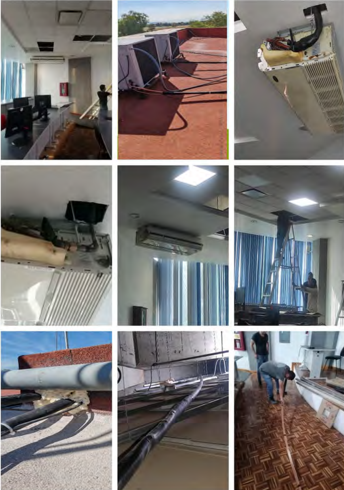
Imagen 5. Mantenimiento de aires acondicionados sala 4, centro de cómputo.
